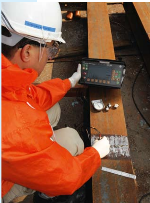
「工」字鋼鐵結構焊接的內部缺陷檢驗
