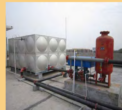
消防水箱及加壓設施
