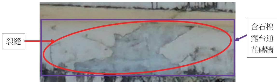
興華(二)邨含石棉露台通花磚牆的裂縫
