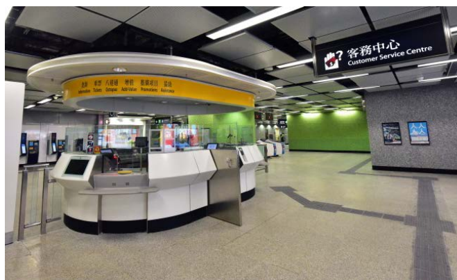
何文田站的車站設施已安裝。
