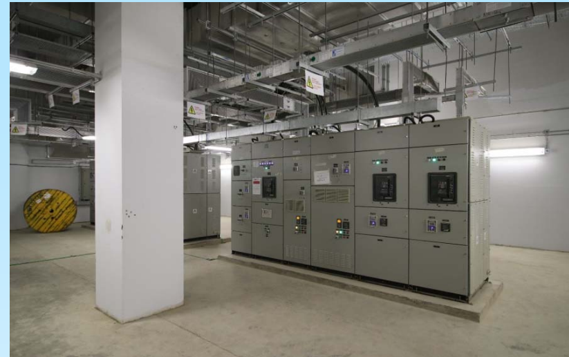
冷氣掣櫃現時運作正常
