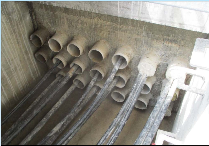
未有封好的管道
