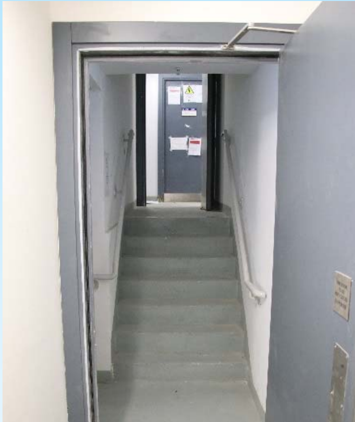
主要電掣房地台升高約1.2米
