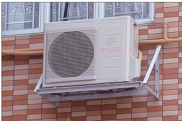
支承空調機的支架
