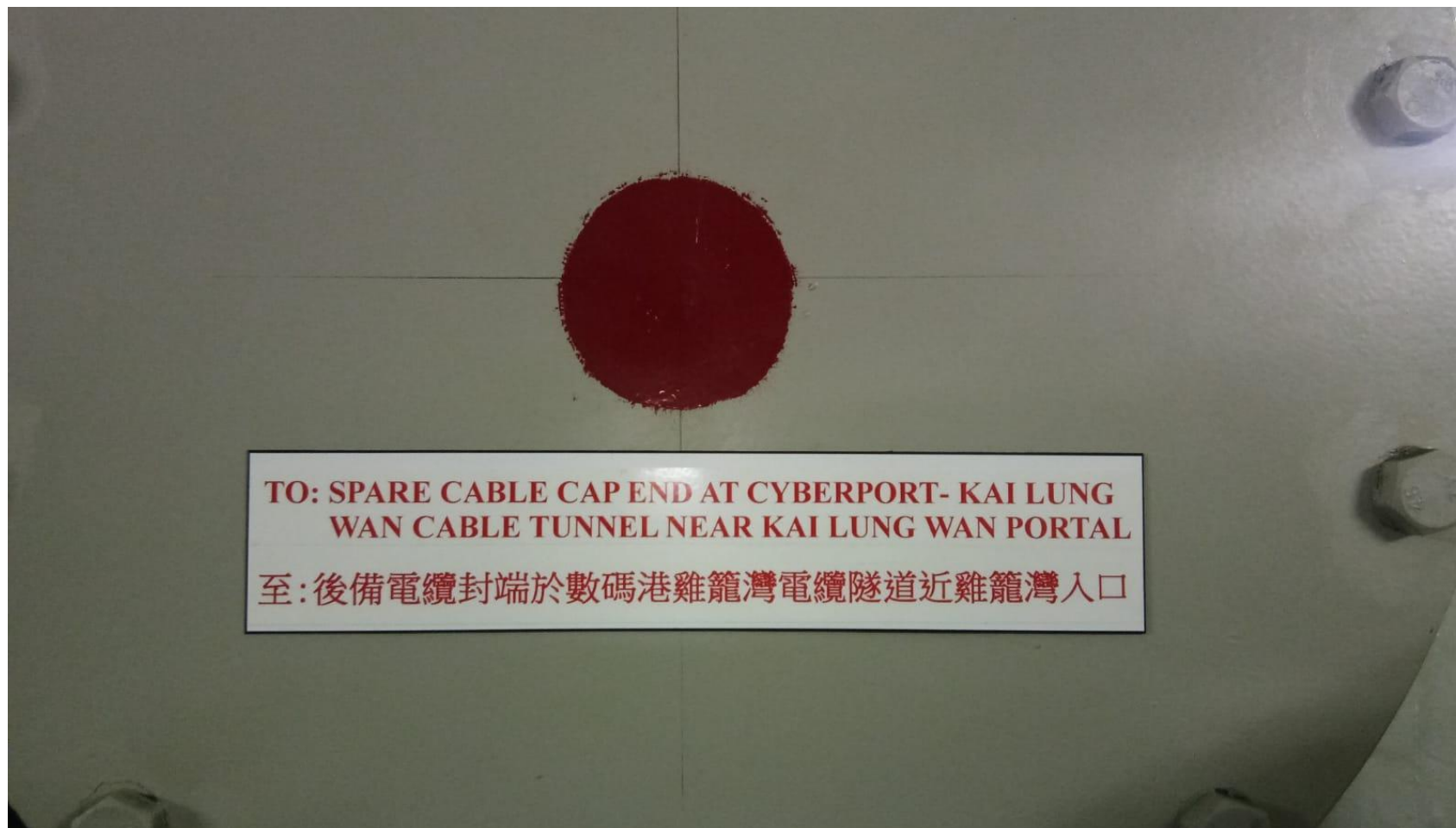
圖像 6. 數碼港電力開關站電纜連接缸的新標籤
