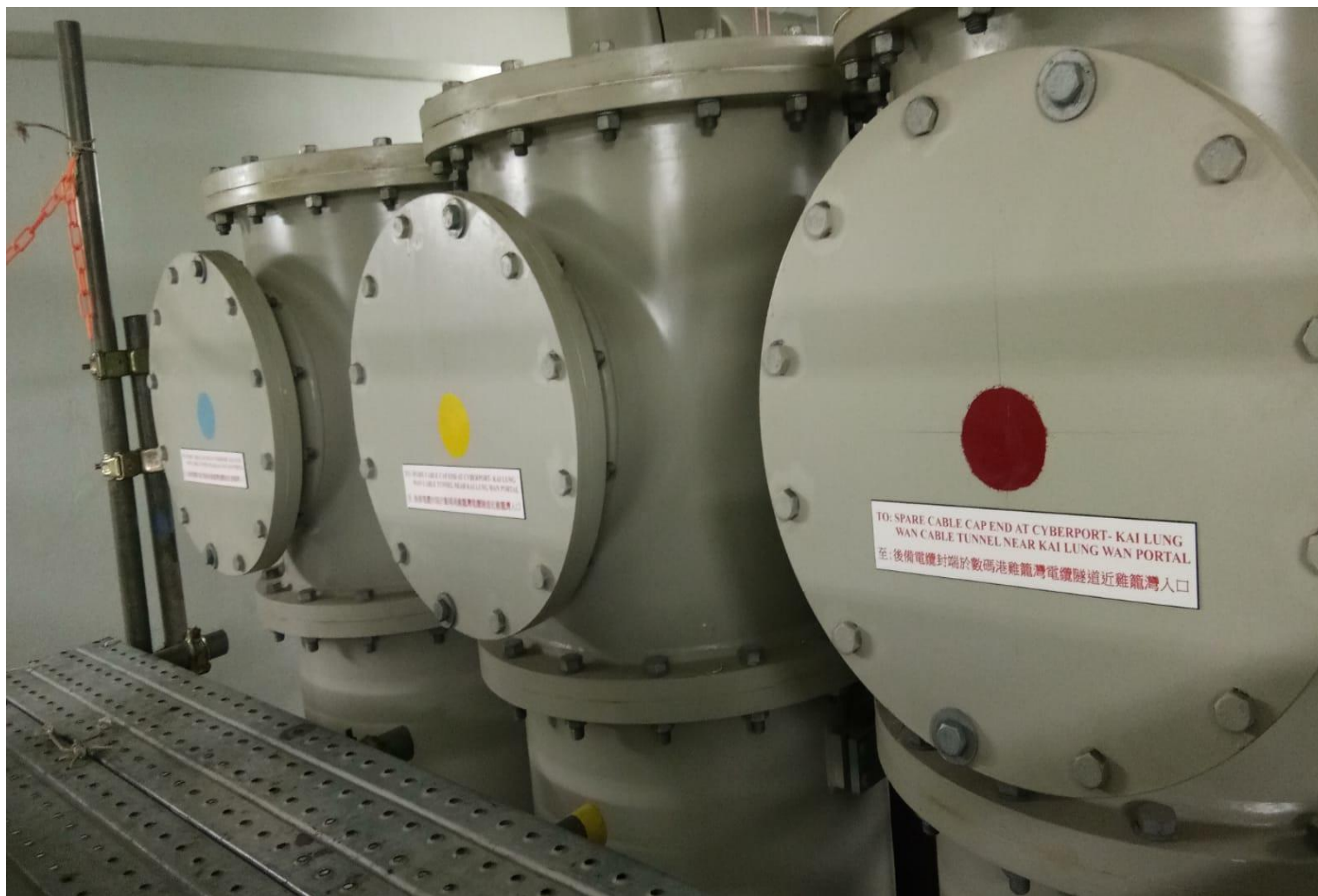
圖像 5. 數碼港電力開關站電纜連接缸的新標籤
