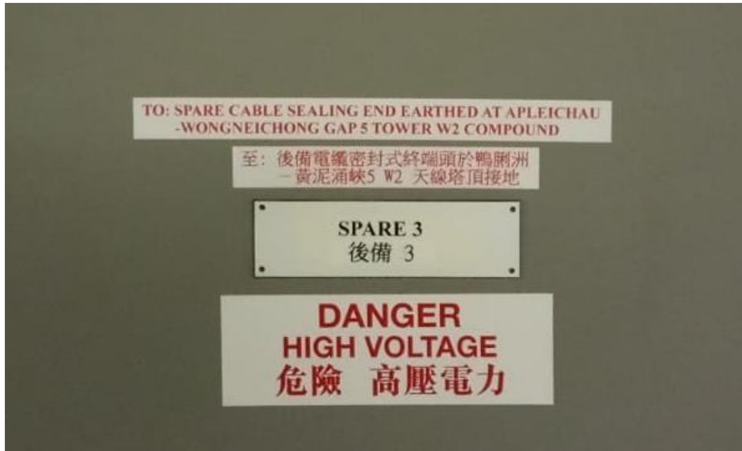
圖像 7. 鴨脷洲 132 千伏電力開關站電纜連接缸的新標籤
