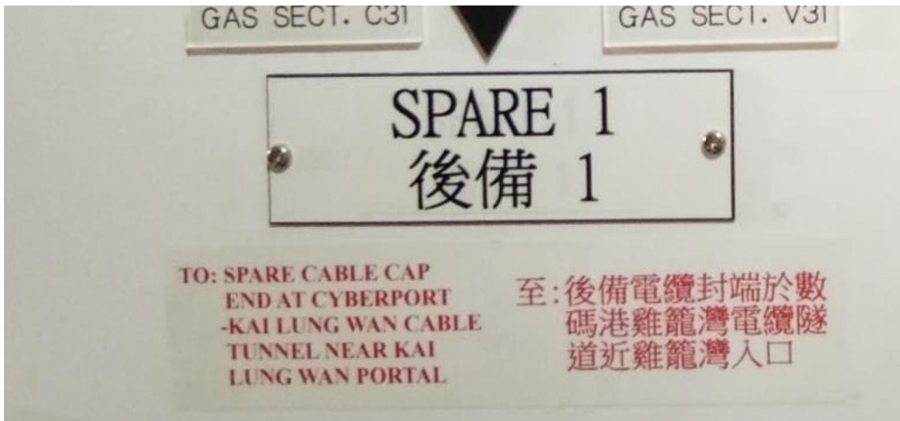
圖像 4. 數碼港電力開關站本地控制面板上的新標籤
