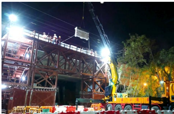
屯馬綫洪水橋站 - 移除高架橋護牆 Hung Shui Kiu Station – parapet removal
